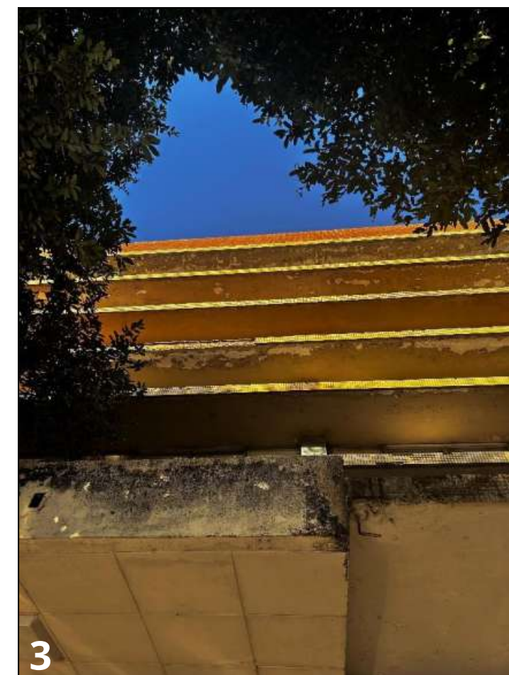
3 pastilhas faltantes, manchas escuras, deslocamento do reboco e sujidades aderidas na fachada frontal. fonte.: imagens do consórcio
