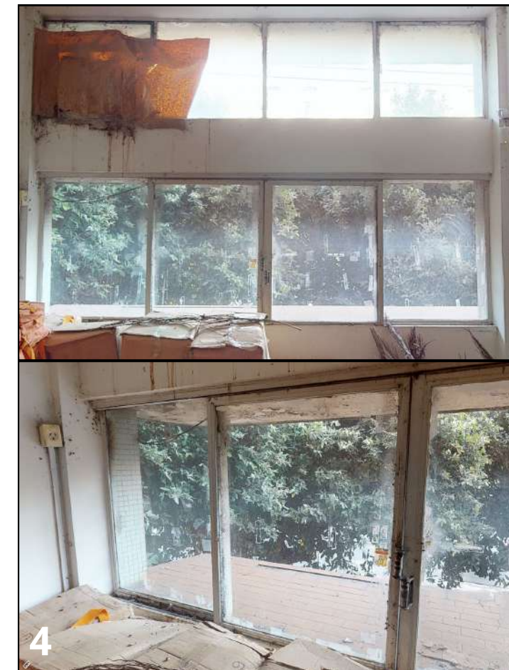
4 esquadrias com sujidades e danos na pintura, necessitando reparos. fonte.: imagens do consórcio
